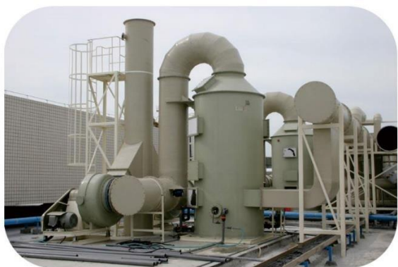
废气处理项目
