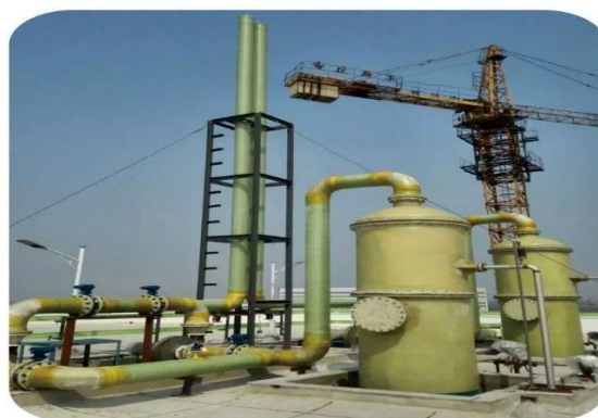
有机废气治理
