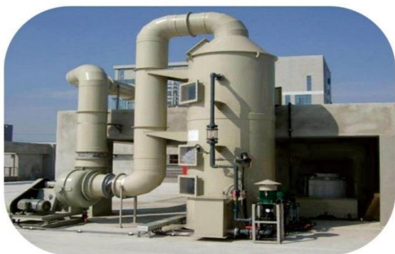
PP废气治理
